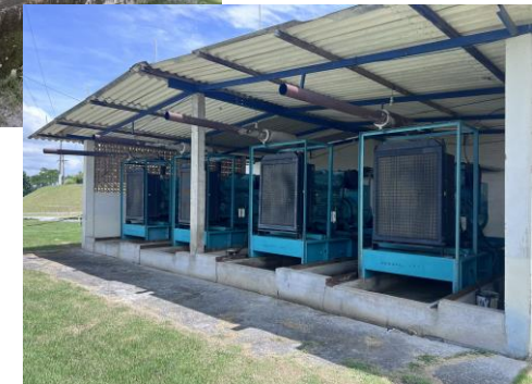
Geradores nas principais unidades
