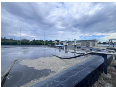
Reatores de Lodo Ativados em Batelada
